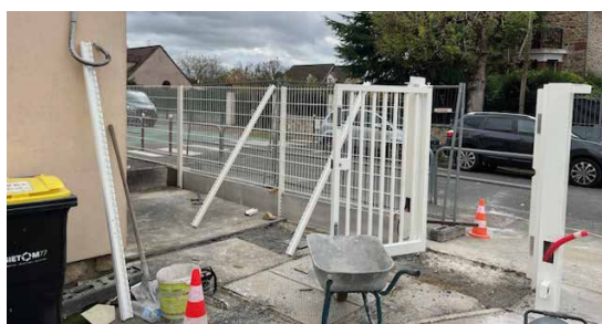
Réfection du portail de l'entrée du parking des professeurs à l'école Georges Travers
